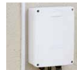
Armoire de commande
